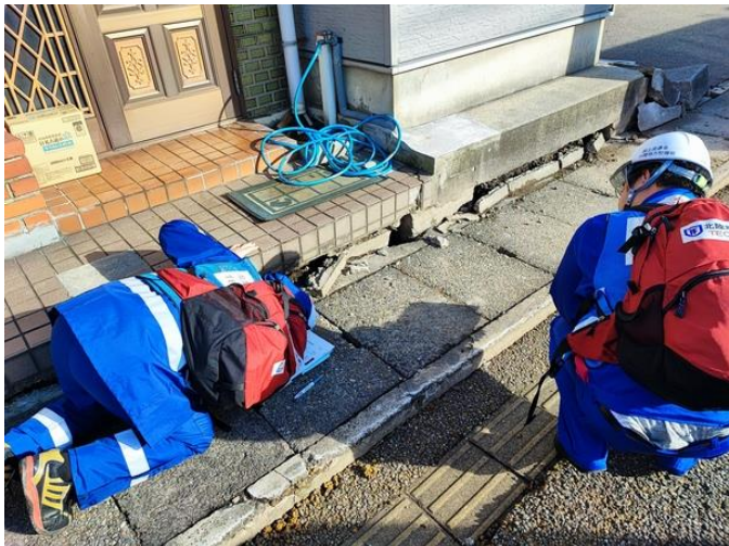
石川県穴水町川島
