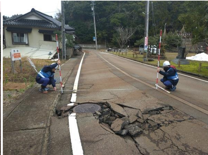
石川県珠洲市上戸町
