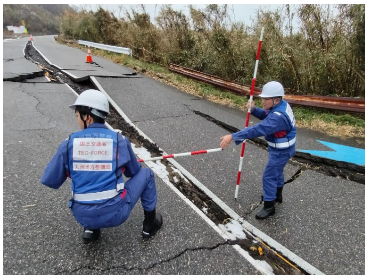
△現地調査の状況（輪島市町野町）
