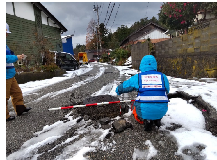
△現地調査の状況（輪島市平成町）
