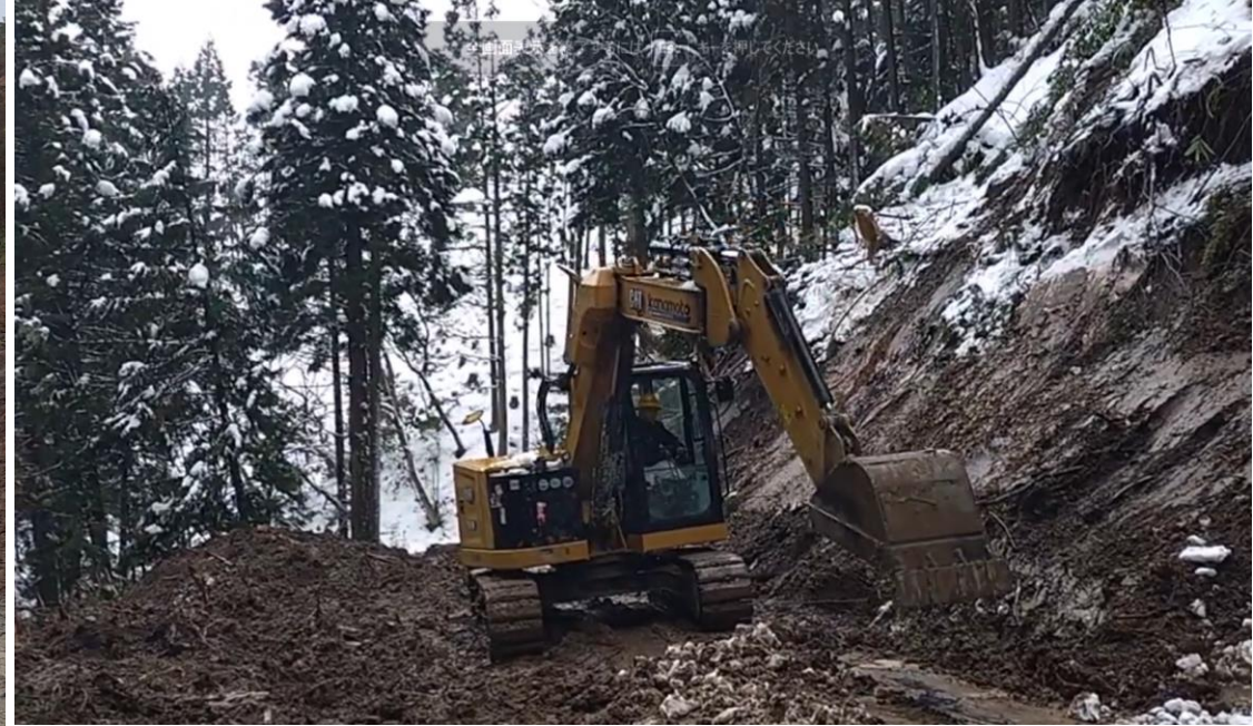
県道38号（輪島浦上線）輪島市門前町浦上付近
