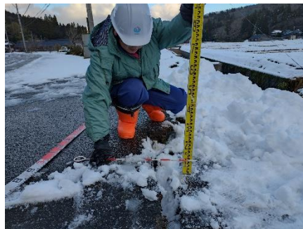
第3班 志賀町被災状況調査
