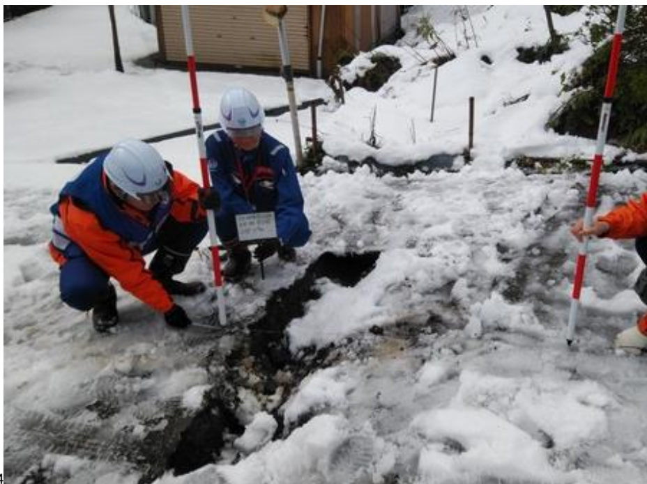
【被災現況調査】路面の段差確認(穴水町内)
