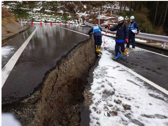
(志賀町大福寺等の被災状況調査等実施)
