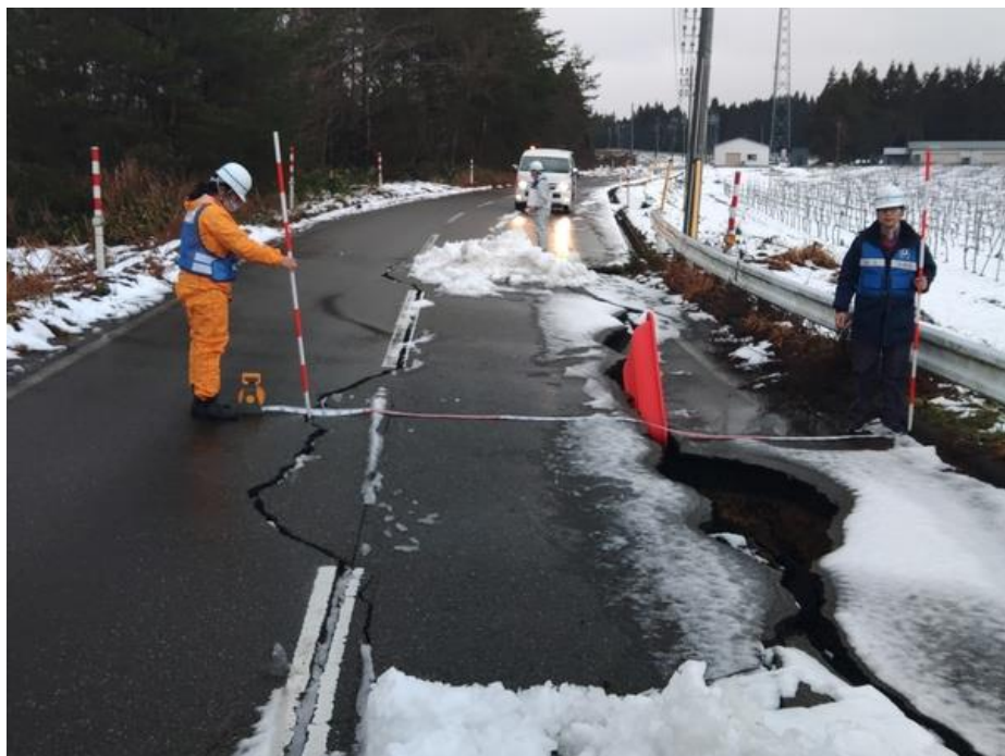
【被災状況調査】路面クラック(穴水町字山中)
