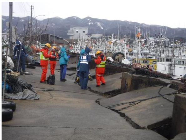
輪島港 被災状況調査
