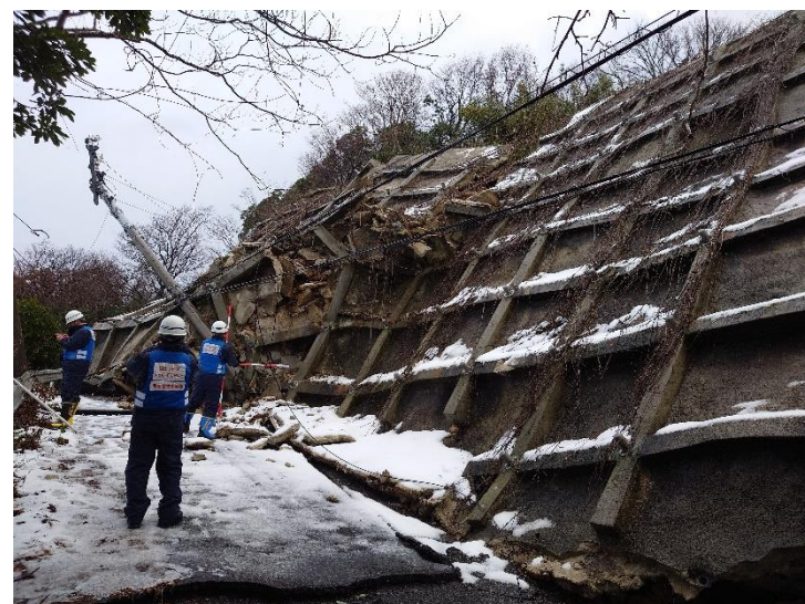
被害状況調査(石川県輪島市稲舟町)
