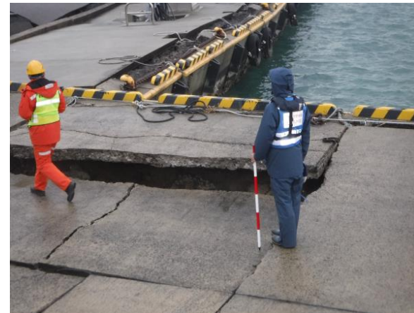
輪島港 被災状況調査
