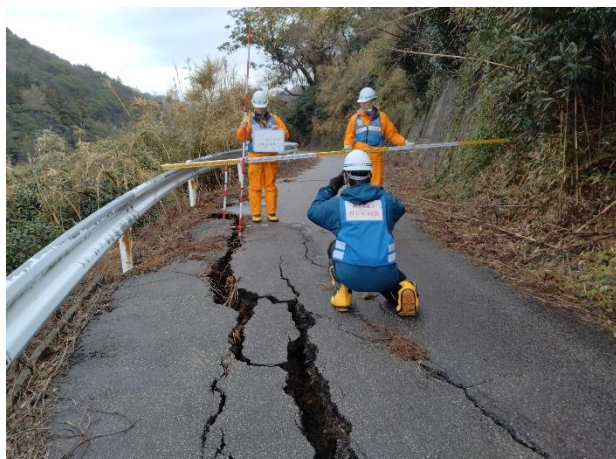
被害状況調査(石川県志賀町富来七海)
