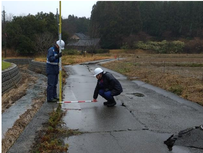
第3班 志賀町被災状況調査
