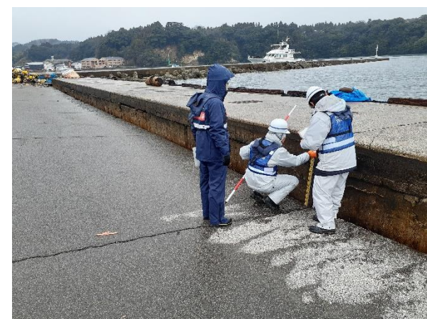
宇出津港 被災状況調査
