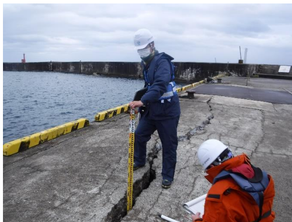
小木港 被災状況調査
