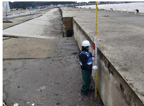
輪島港 被災状況調査
