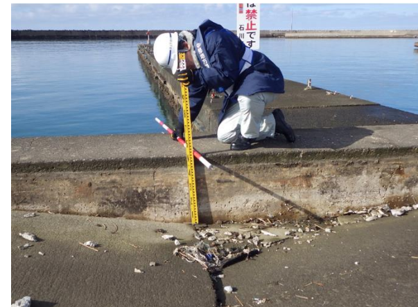
滝港 被災状況調査
