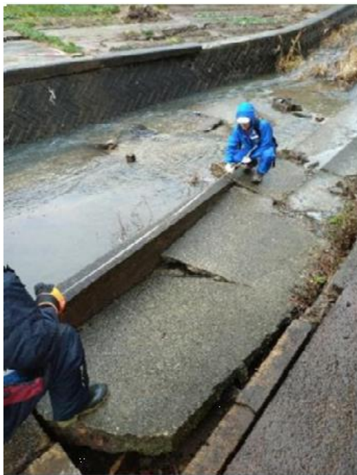
第2班 能登町護岸被災状況調査
