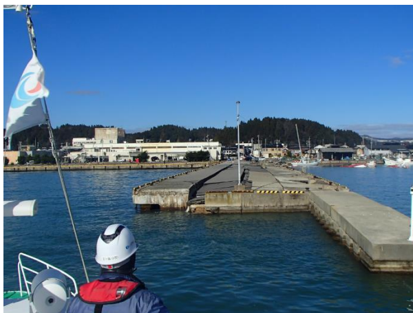
飯田港 被災状況調査(港湾業務艇「わかなⅡ」からの施設点検)
