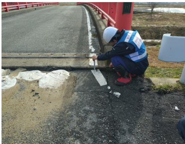
第5班 中能登町橋梁被災状況調査
