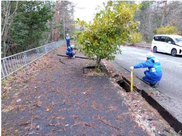
被災状況調査班(道路)
