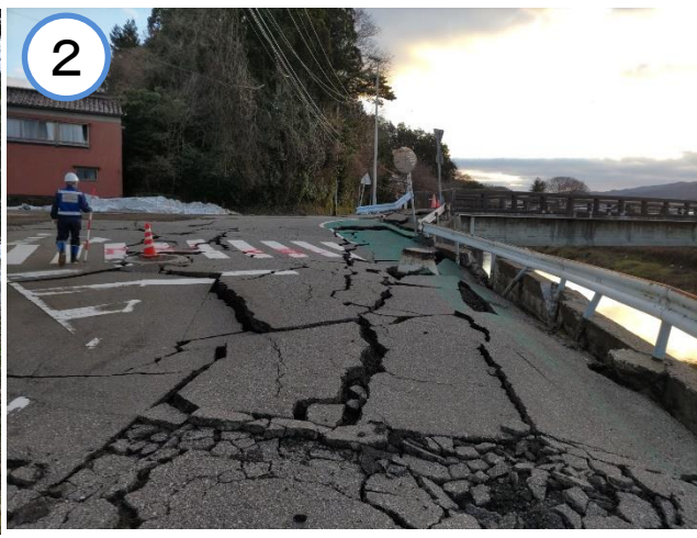
市道 被災状況調査 (輪島市鳳至町)
