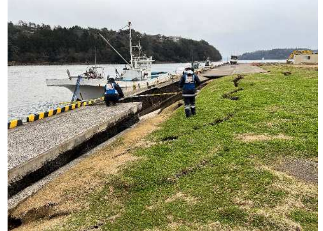
(穴水港の被災状況調査等実施)
