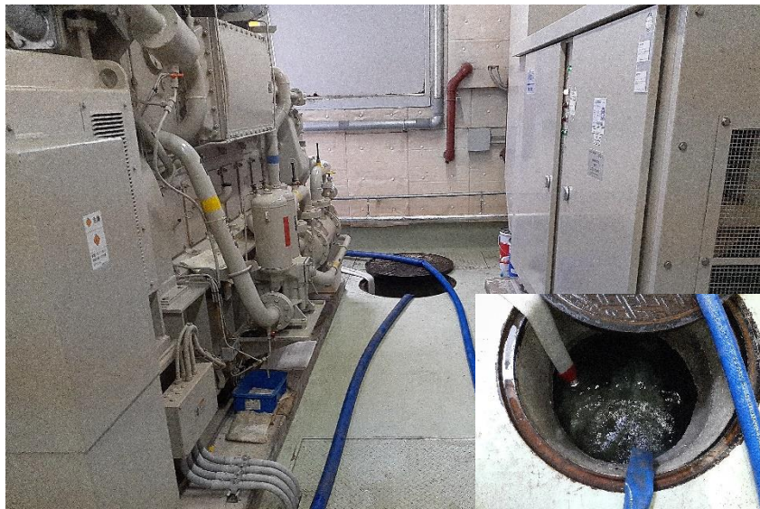
地下貯水タンクに水を給水
