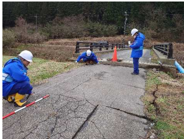
(志賀町内の被災状況調査等実施)
