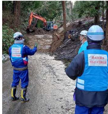
被災状況調査班(砂防)
