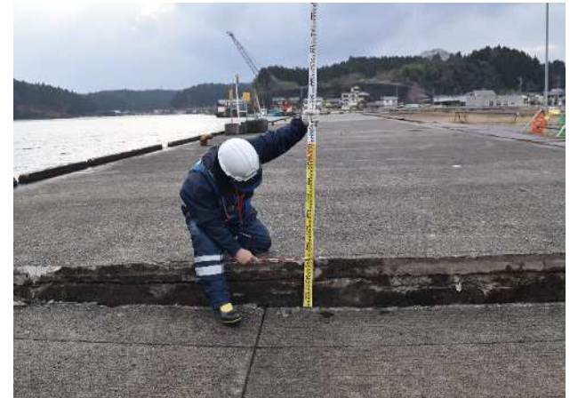
被災状況調査(港湾)
