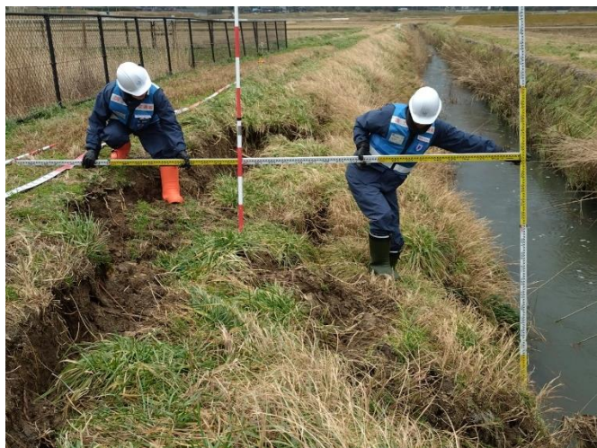
第3班 志賀町被災状況調査
