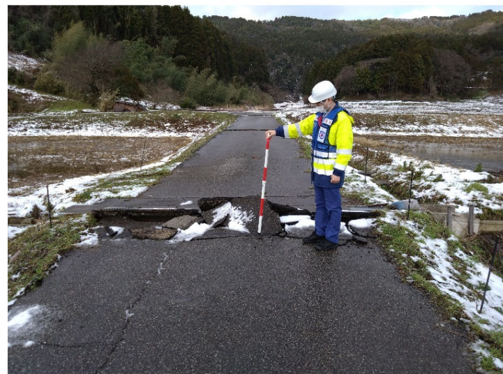
△ 現地調査状況（輪島市門前町）
