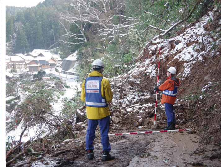
△ 現地調査状況（輪島市町野町）
