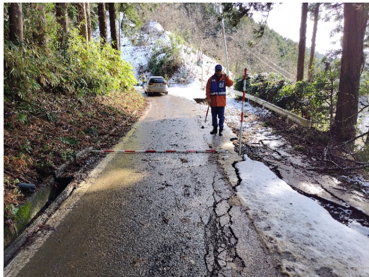
△ 現地調査状況（輪島市里町）
