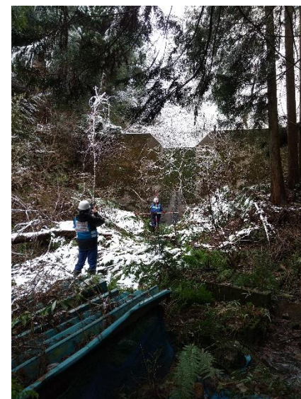
被害状況調査(石川県志賀町酒見)
