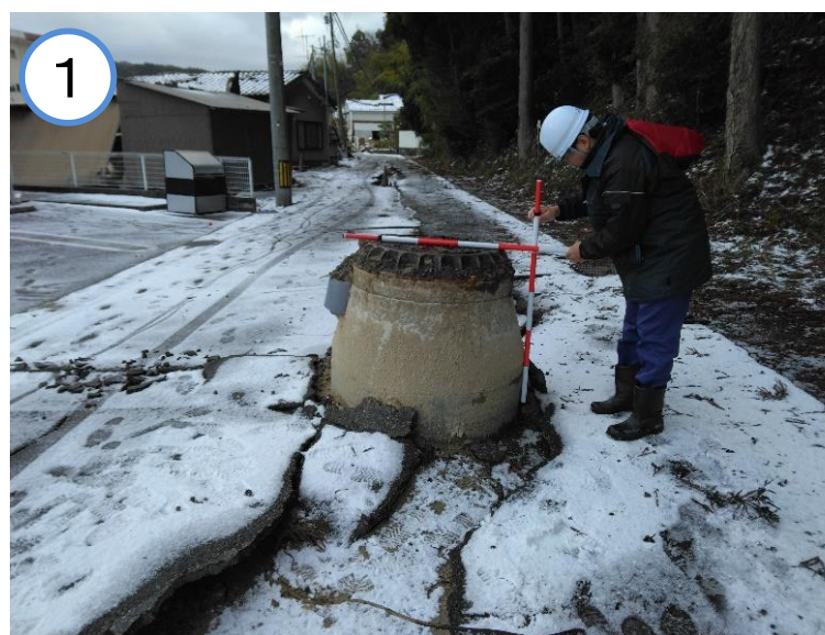
被災状況調査（輪島市山岸町）
