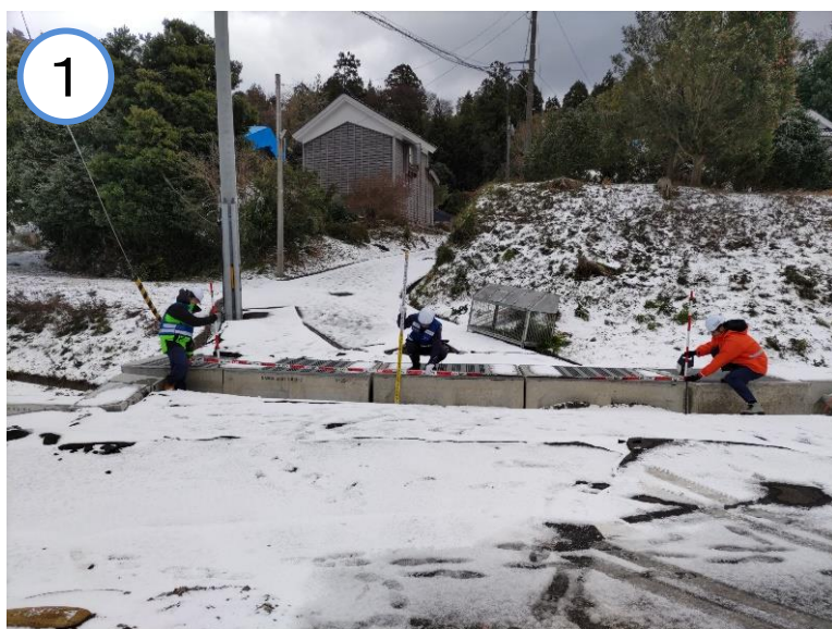
被災状況調査（輪島市杉平町）
