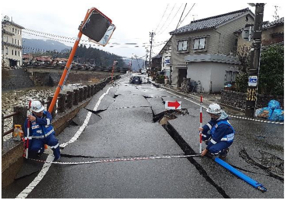
【被災状況調査班】
