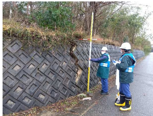
(志賀町内での被災状況調査)
