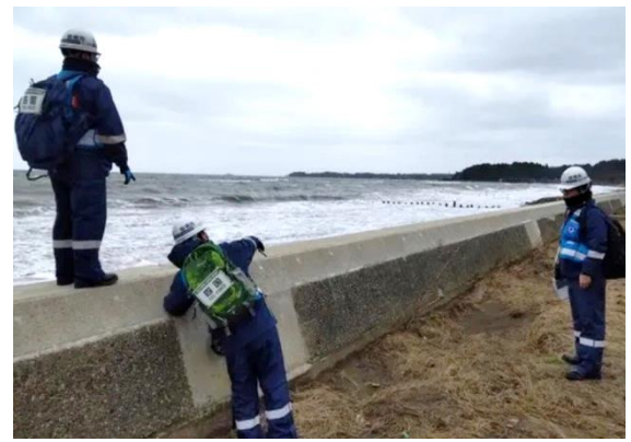
【被災状況調査班】
