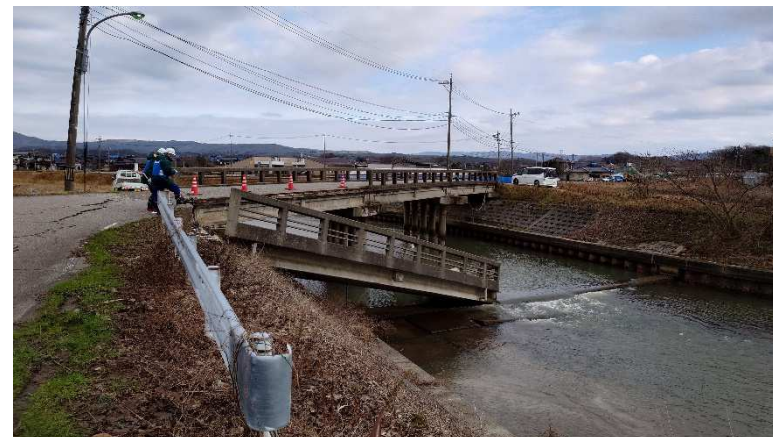
(志賀町内での被災状況調査)
