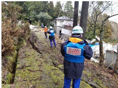
【被災状況調査班】
