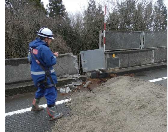
(穴水町での被災状況調査)
