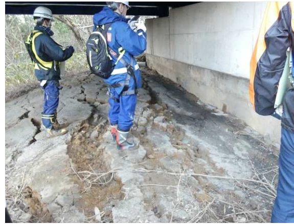
(七尾市での被災状況調査)
