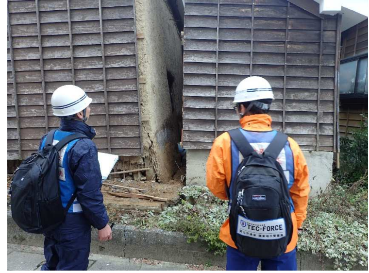
(珠洲市内での被災状況調査)
