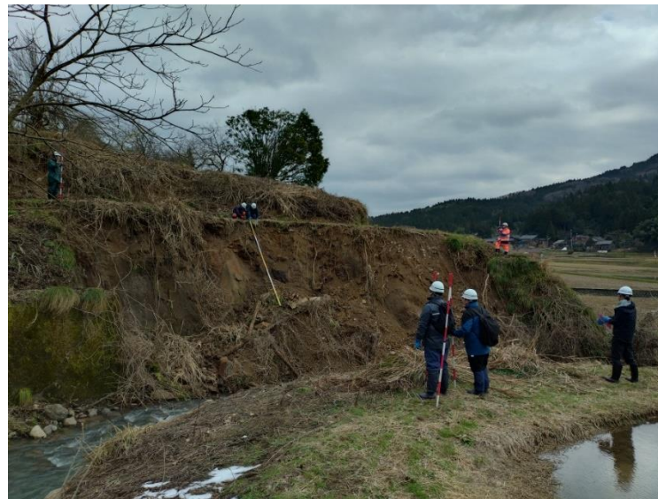
第6班 輪島市 河岸被災状況調査
