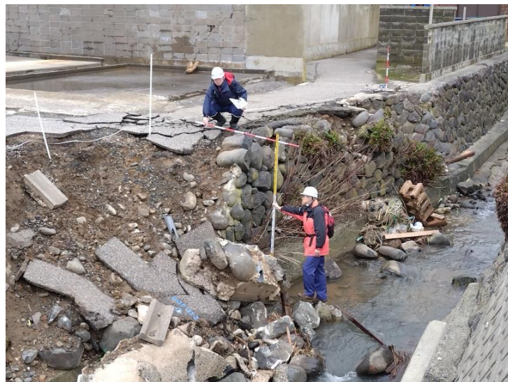
第2班 志賀町 護岸被災状況調査
