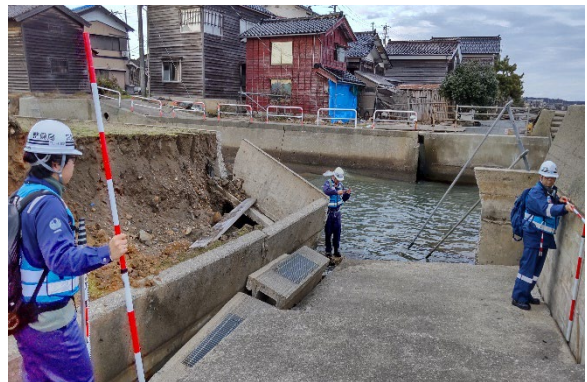
【被災状況調査班】
