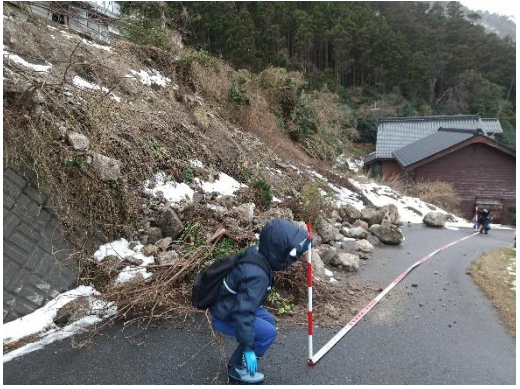
【被災状況調査班】
