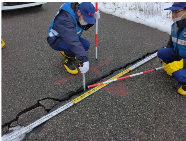
(志賀町内での被災状況調査)
