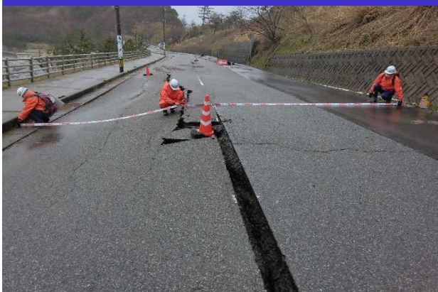
①被災状況調査（輪島市）
