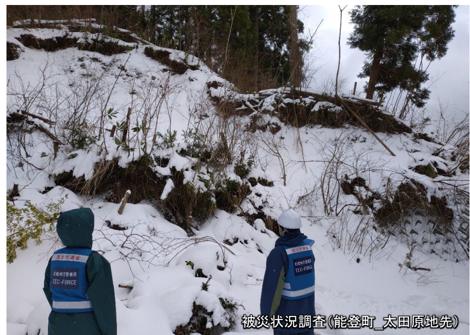
被災状況調査(輪島市_町野町東大野地先)
