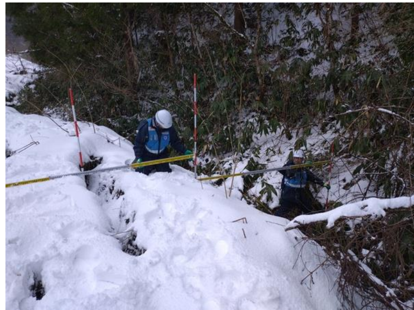
第5班 和島市 護岸被災状況調査
