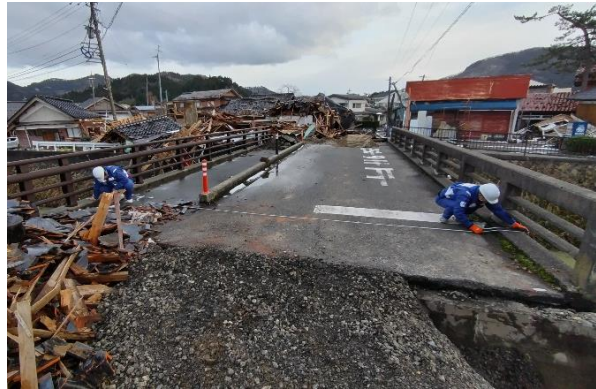
【被害状況調査班】
