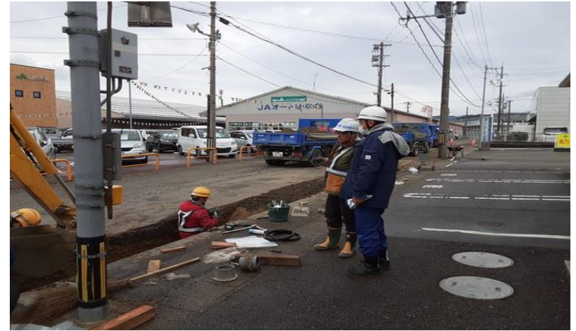
○七尾市藤橋町における調査【水道支援班】
