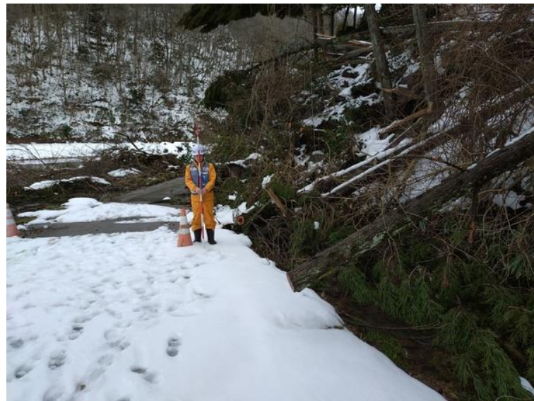
第2班 能登町 被災状況調査
