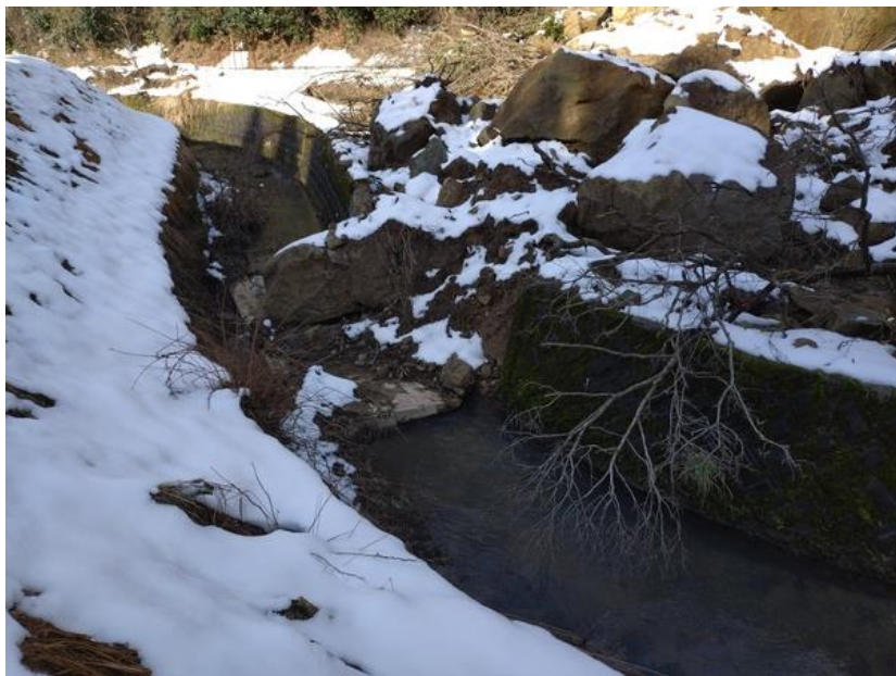
第2班 能登町 被災状況調査
