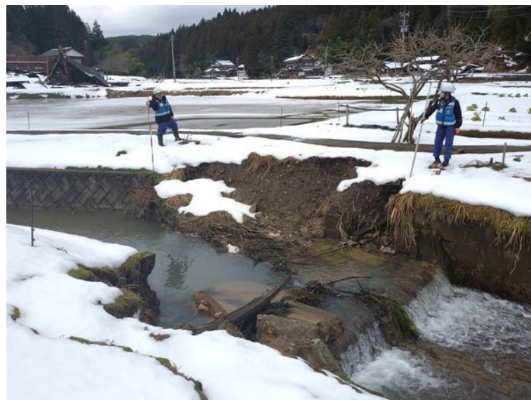
第1班 珠洲市 被災状況調査
