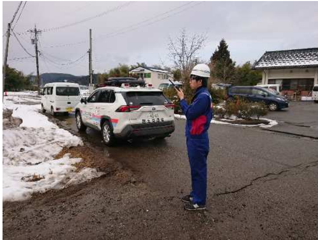
(珠洲市内での被災状況調査)
