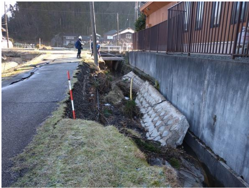
輪島市 被災状況調査
