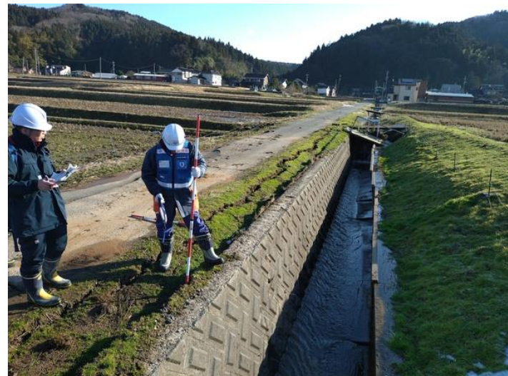
輪島市 被災状況調査
