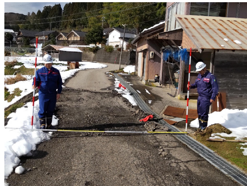
被災状況調査（輪島市大屋地区）
