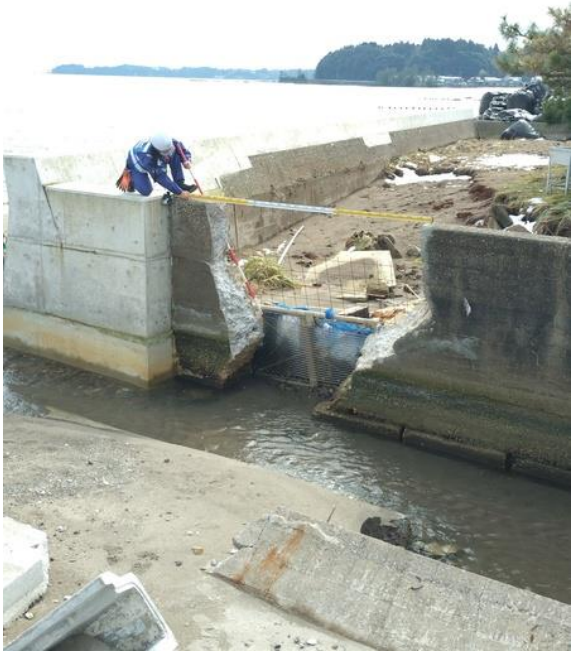
珠洲市 被災状況調査
