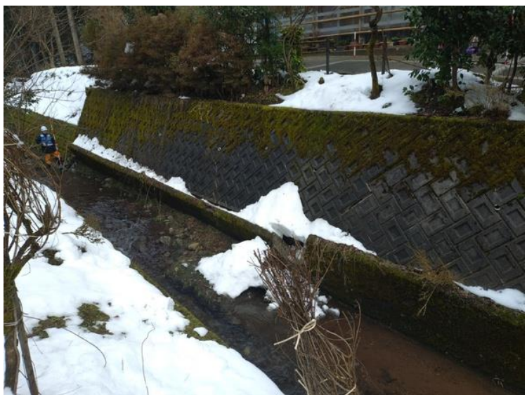
能登町 被災状況調査
