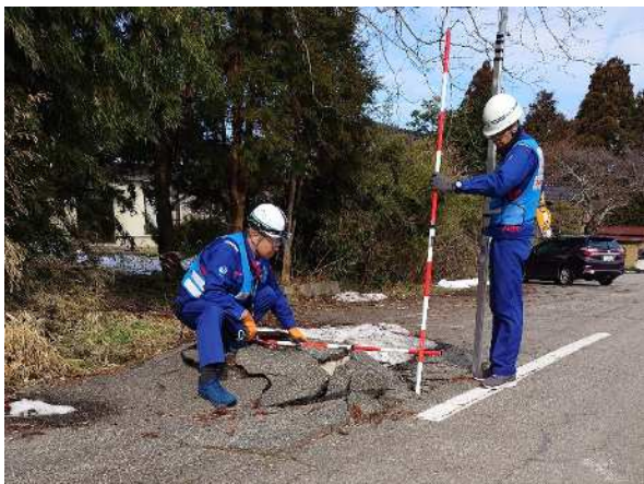
(能登町内での被災状況調査)
