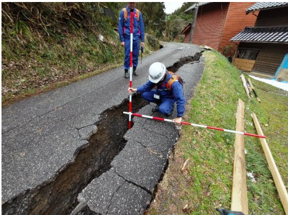
【被害状況調査班】
