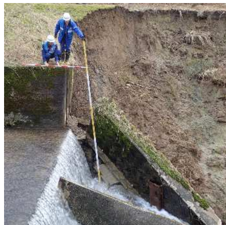
(輪島市内での被災状況調査)
