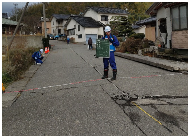
【道路班】輪島市 被災状況調査（6日）
