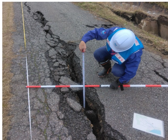
【道路班】輪島市 被災状況調査（6日）
