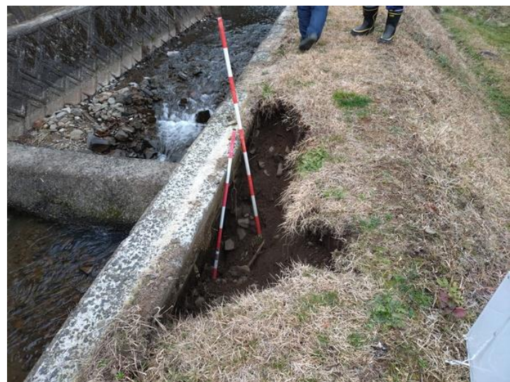
能登町 被災状況調査
