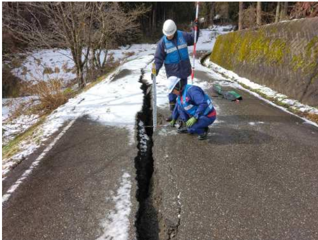
(能登町内での被災状況調査)
