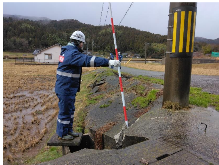
被災状況調査（輪島市下黒川町）
