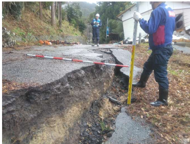
【道路班】輪島市 被災状況調査（8日）
