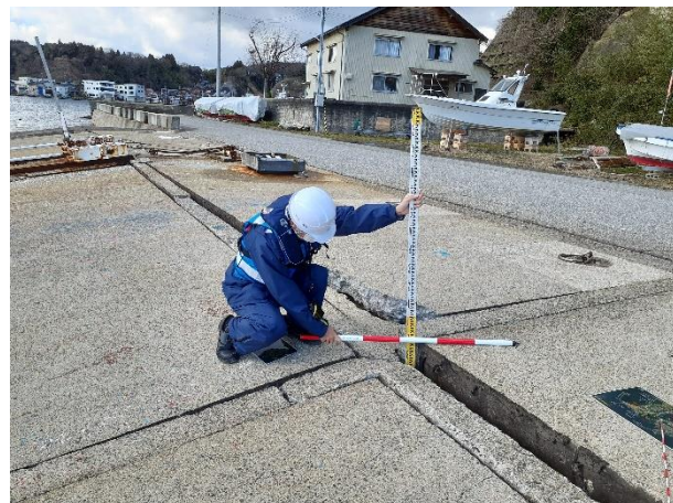
小木港における被災状況調査
