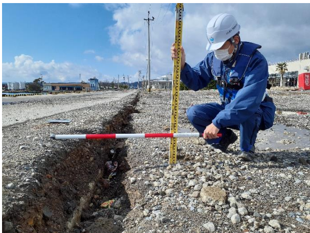
飯田港における被災状況調査
