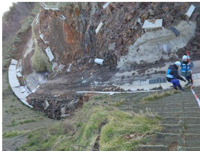
【道路班】輪島市 被災状況調査（11日）
