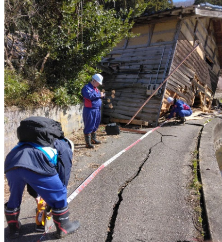
【道路班】 輪島市 被災状況調査（13日）
