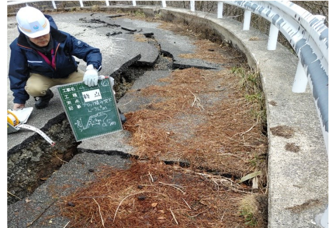
【被害状況調査班】
