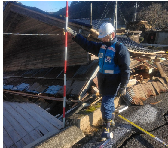
【道路班】 輪島市 被災状況調査（13日）
