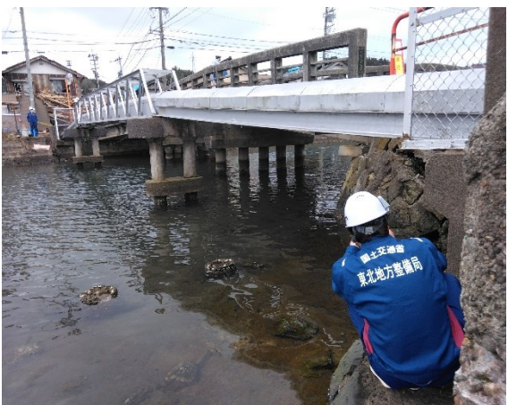
【被害状況調査班】
