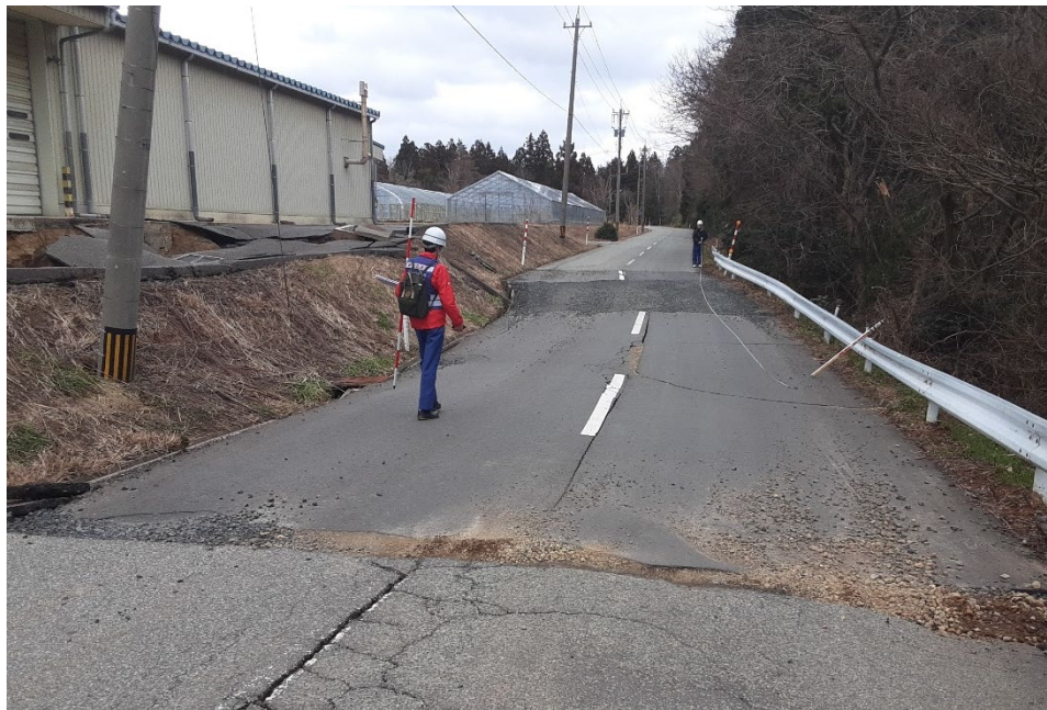
珠洲市内にて現地調査【道路班】
