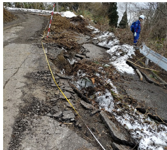
【道路班】輪島市 被災状況調査（15日）
