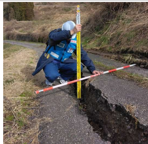
【道路班】輪島市 被災状況調査（16日）
