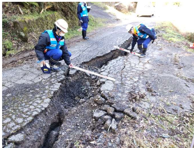
【道路班】輪島市 被災状況調査（16日）
