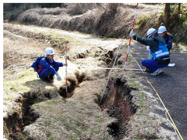
【道路班】輪島市 被災状況調査（17日）
