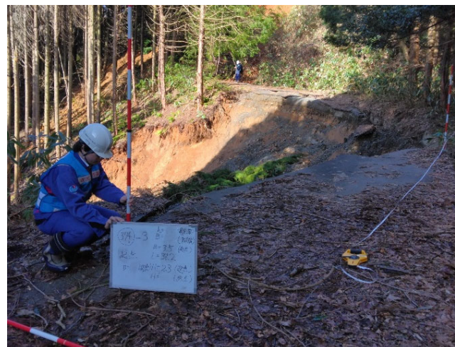
【道路班】輪島市 被災状況調査（17日）
