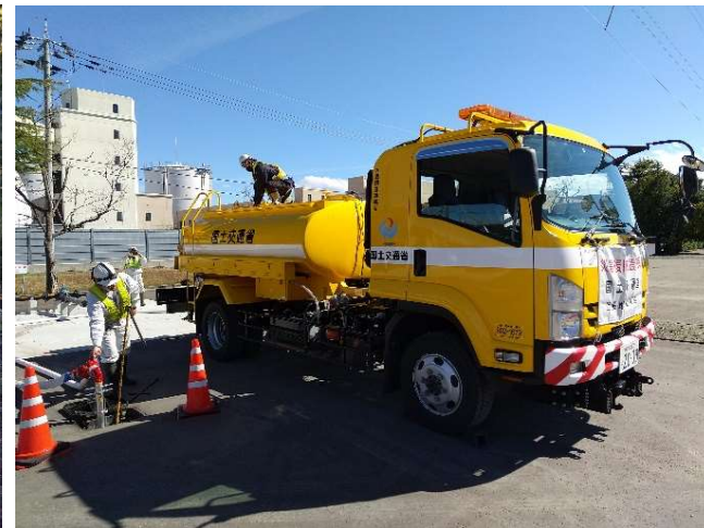
【給水班】金沢市 補水状況（18日）
