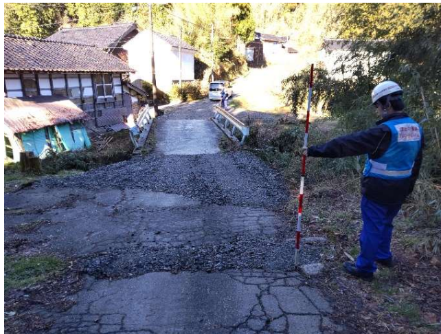
【道路班】輪島市 被災状況調査（18日）
