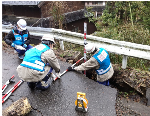
【道路班】輪島市 被災状況調査（20日）
