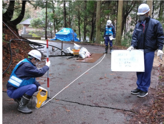
【道路班】輪島市 被災状況調査（20日）
