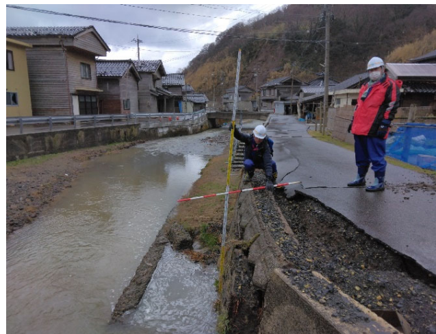
【道路班】輪島市 被災状況調査（23日）
