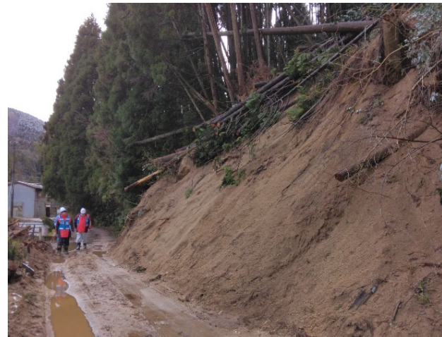
【道路班】輪島市 被災状況調査（22日）
