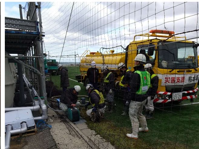
【給水班】輪島市 給水状況（26日）
