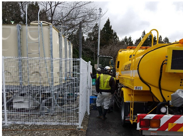
【給水班】輪島市 給水状況（27日）
